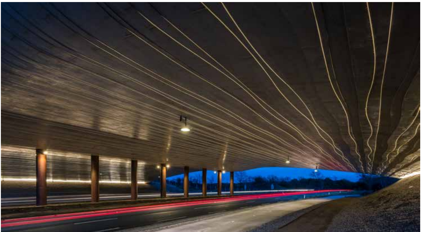
FIJNE GOLVENDE LIJNEN AAN DE ONDERZIJDE VAN DE BRUG
