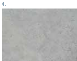
4. Randelement, schoon prefab beton, gladbekist, wit en behandeld met anti- algenmiddel
